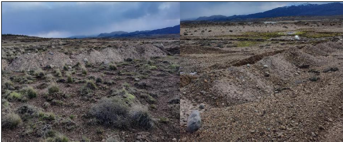
Figura19: Zona de entrada al área de Pueblo Carao, en los primeros movimientos de suelo. Se puede observar el dominio de las facciones arenosas y de grava en superficie.
